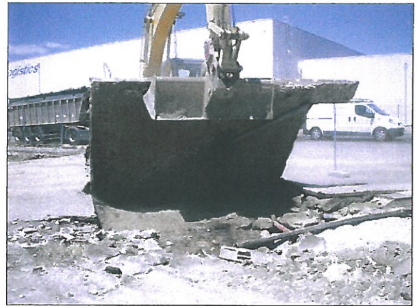
Démolition et fin des terrassements sous la dalle de dépotage du réservoir enterré de 15 m 3
