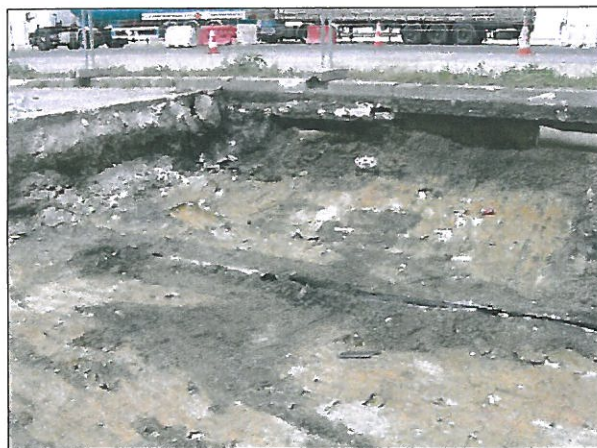
Mise en évidence d'une canalisation électrique au droit de la piste de distribution
