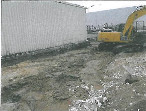
Terrassement jusqu'à environ 1 m de profondeur (couche d'argile ne présentant pas de constats organoleptiques de pollution en fond de fouille) au droit des anciens réservoirs aériens
