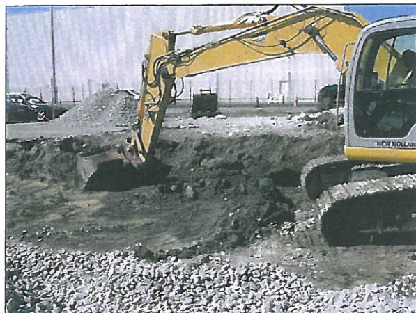
Démolition de la clôture et poursuite du terrassement au droit de la piste de distribution
