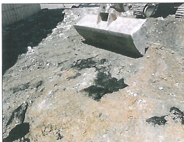
Mise en évidence d'un géotextile souillé aux hydrocarbures au droit de la zone terrassé
